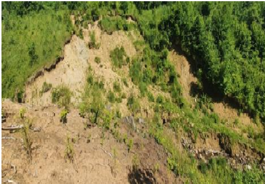
Fig. 2 Landslides in P.U. I, a.u. 43 A
